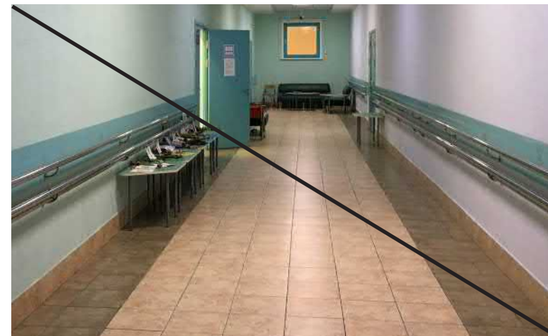
Плохо Керамогранитная плитка с крупными швами
