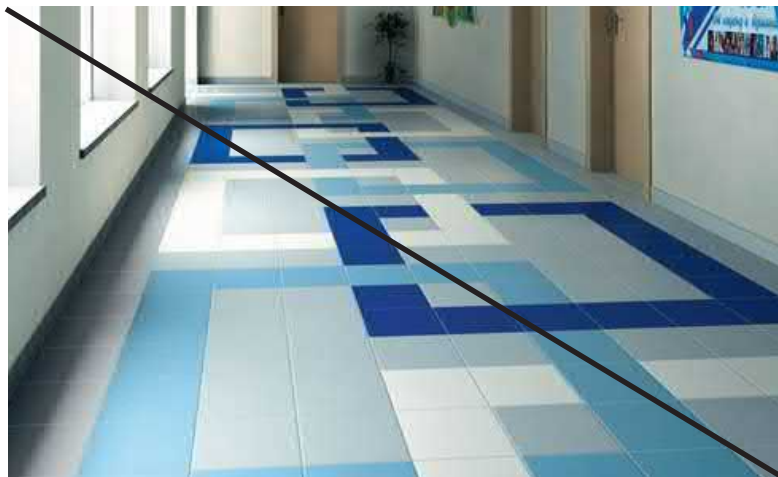
Плохо Цветные вставки из плитки
